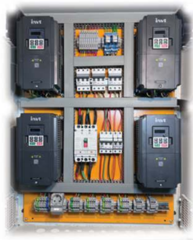
تابلو برق تمام هوشمند VFD
